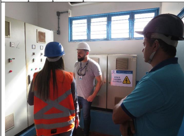
Autor: AMAE/RIO VERDE Descrição: Quadros de comando.
