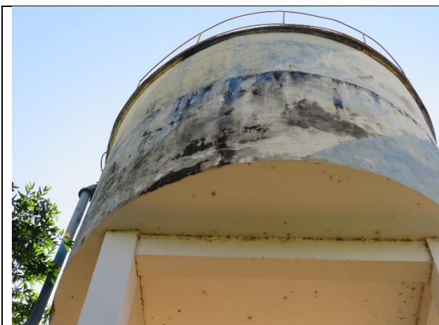
Autor: AMAE/RIO VERDE Descrição: Vazamento na parede do reservatório.
