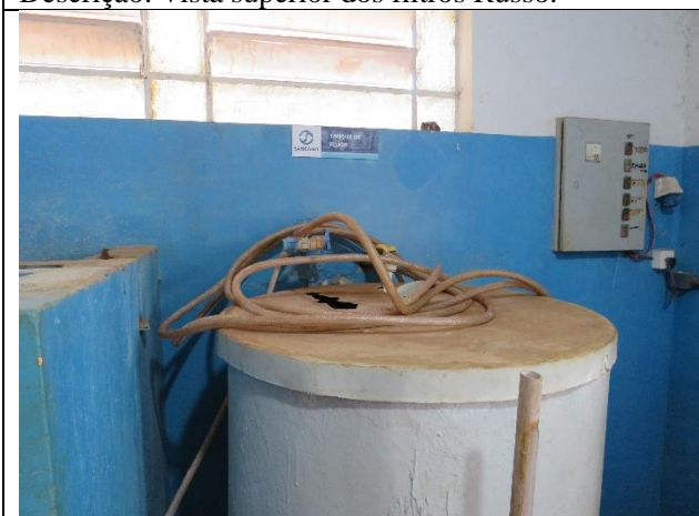
Autor: AMAE/RIO VERDE Descrição: Tanque de flúor.
