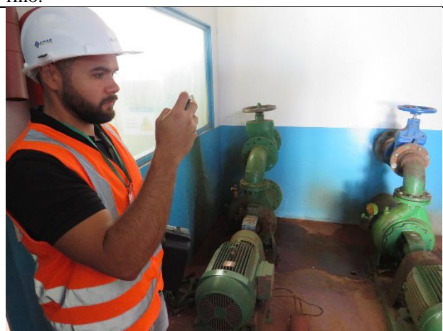
Autor: AMAE/RIO VERDE Descrição: Bombas de sucção.
