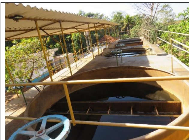
Autor: AMAE/RIO VERDE Descrição: Vista superior dos filtros Russo.
