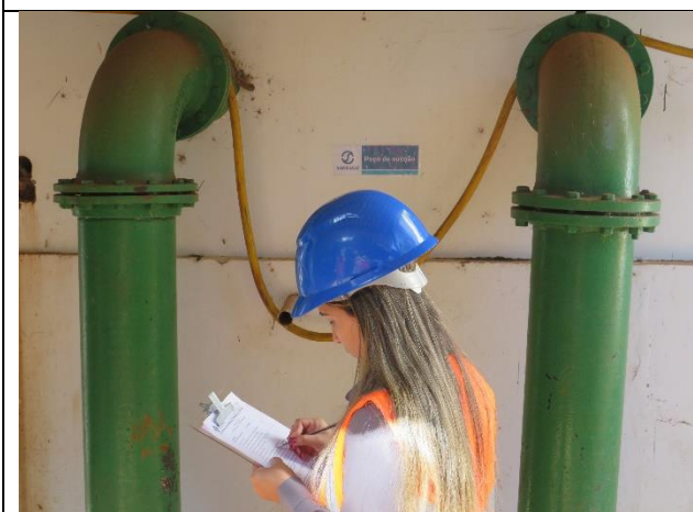
Autor: AMAE/RIO VERDE Descrição: Poço de sucção.
